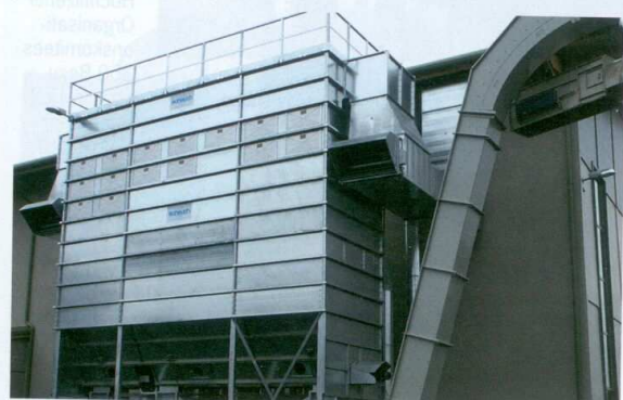
Filteranlage von Scheuch sorgt für zuverlässige Absaugung und Entstaubung des Spänematerials
