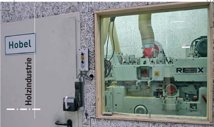
Schallgeschützt und streng gesichert: schwere Hobelmaschine Bigmaster von Rex
